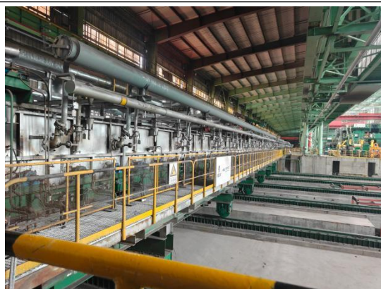
横移式隧道炉（本项目）
