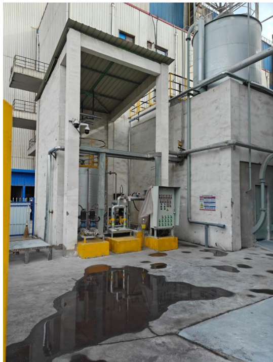
隧道炉氨水储罐
